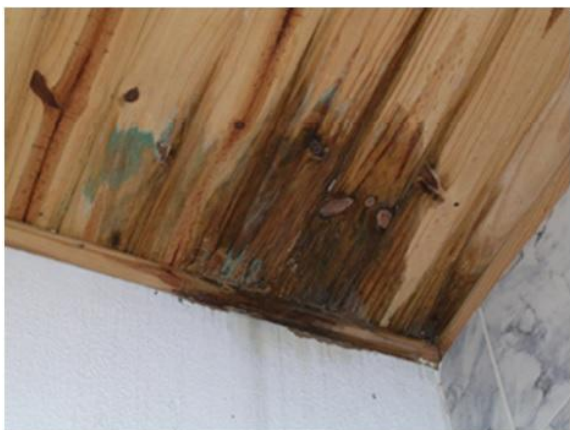
Fig.III.45 Umidade no forro de madeira. Foto do autor, 2007.
