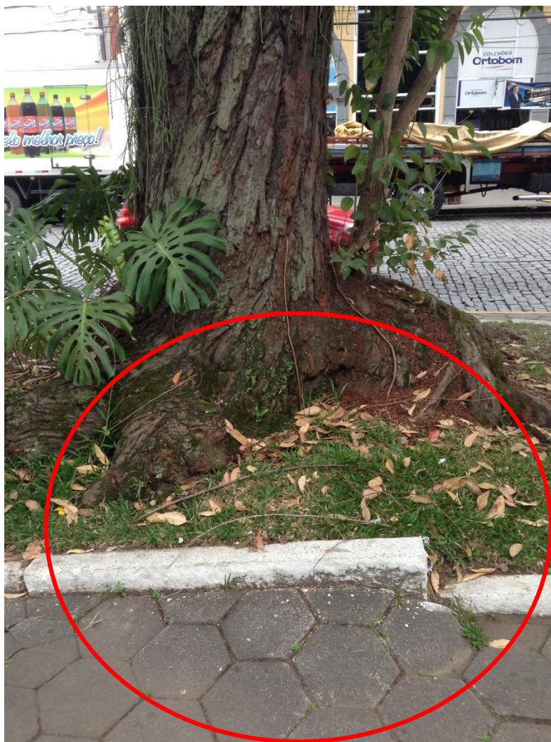
Figura 26. Levantamento da calçada e do passeio causado pela raiz de E. robusta na PGV, Nova Friburgo, RJ.
