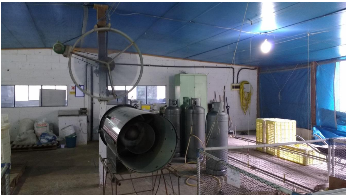
Figura 3 - Sistema de aquecimento e ventilação do galpão experimental do Centro de Pesquisa Avícolas do IFRJ.
