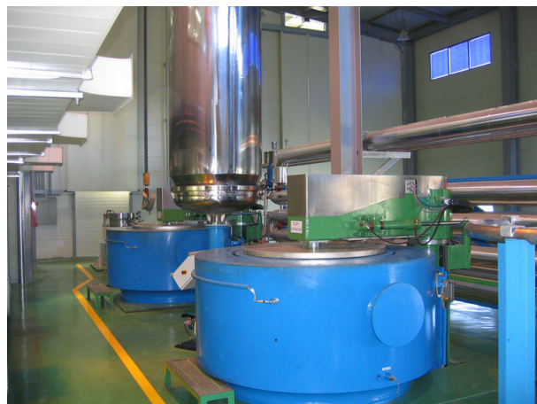
Figura 7 – Planta industrial de extração supercrítica situada na Coreia do Sul (Fonte: http://www.natex.at , 2010)
