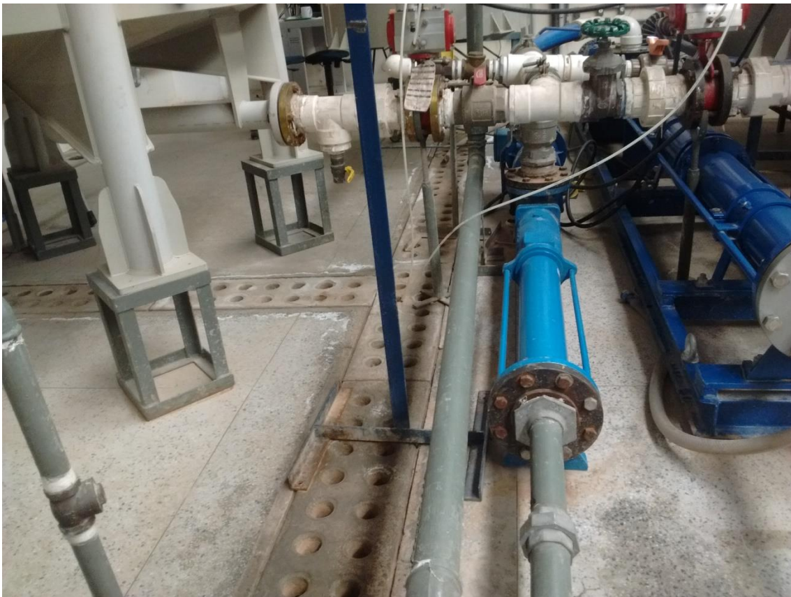
Figura 12 - Bomba Helicoidal conectada aos tanques. Fonte: o Autor.
