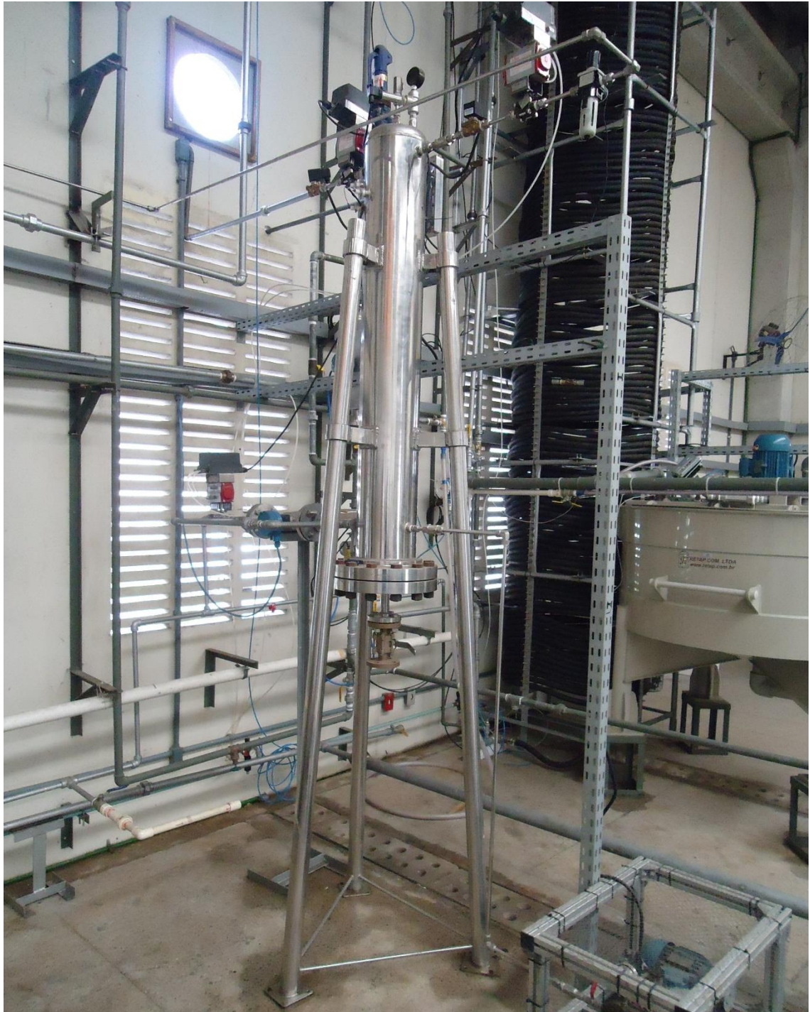
Figura 17- Tanque Reservatório Fonte: o Autor
