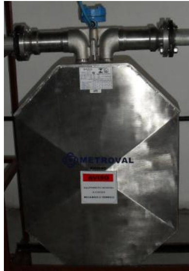
Figura 16: Foto do medidor de vazão e densidade coriollis da unidade.
