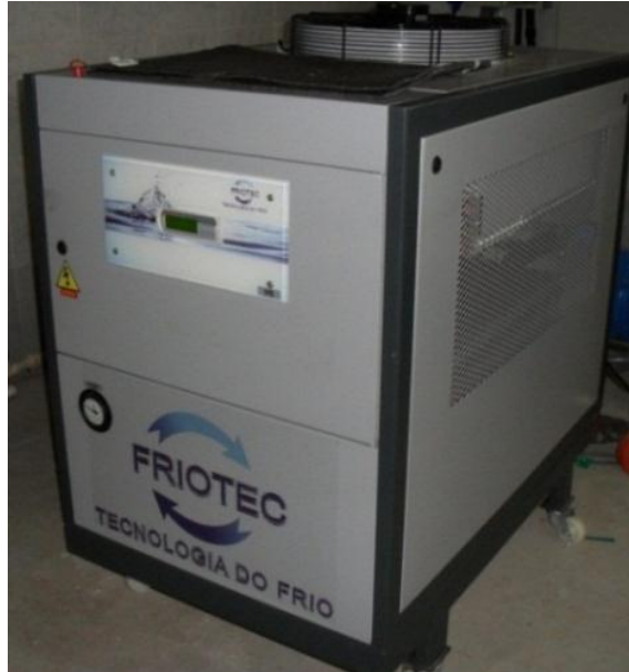
Figura 14: Foto de chiller da unidade experimental.
