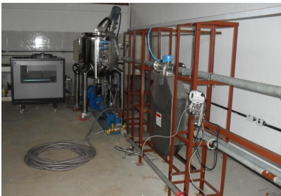
Figura 9: Foto da unidade de simulação de escoamento de fluidos (USEF).
