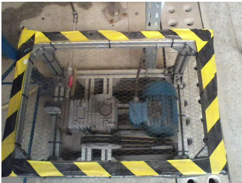
Figura 3.10 - Bomba de reposição de água para tanque de pressão.
