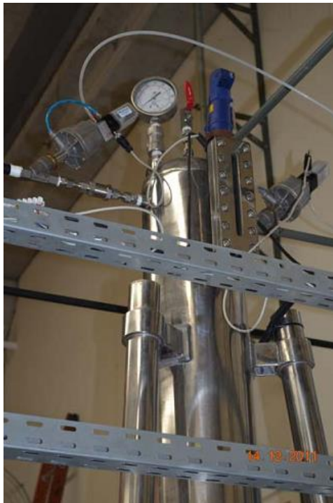
Figura 3.6 - Válvulas de entrada e saída de ar comprimido.
