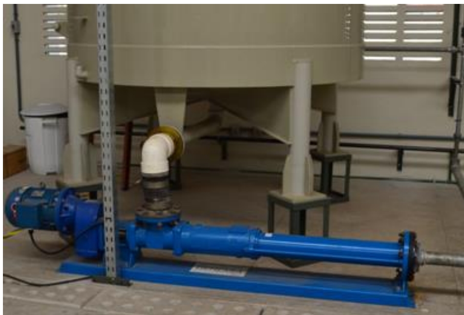
Figura 3.11 - Bomba helicoidal de deslocamento positivo (Bomba principal).
