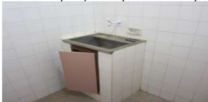
Figura 2 - Pia de dispensação inadequada de resíduos químicos.
