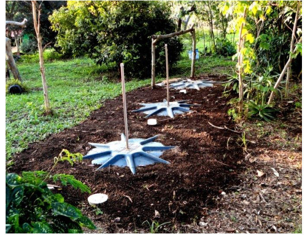
Figura 39: Detalhes da fossa Séptica Biodigestora (2011) (ângulo B)
