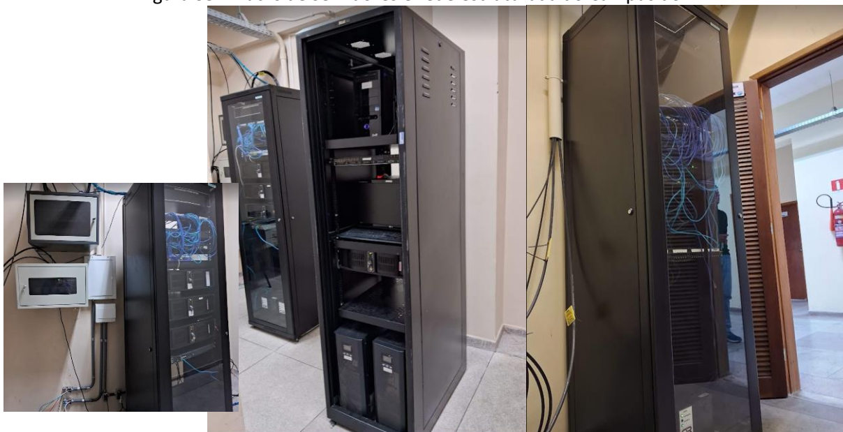
Figura 35 – Racks de servidores e rede estruturada do Campus do ITR
